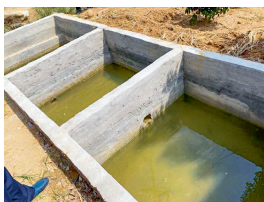
(d) 灰水终端处理生态池
