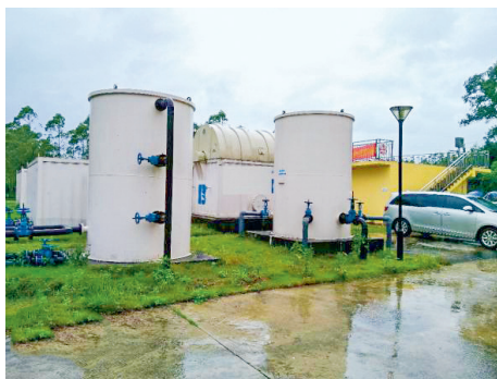
(a) 旺茂镇污水处理厂设施
