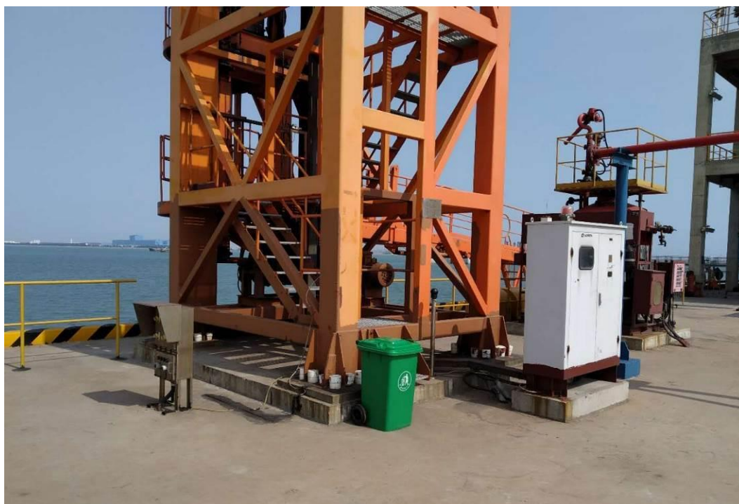
图 5.2-3 码头前沿船舶垃圾收集装置
