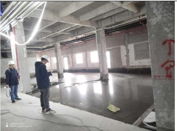
1#门诊医技楼一层急诊中心DSA+CT手术室
