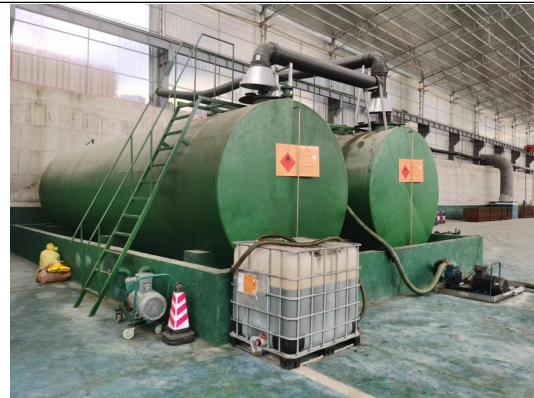
已建成废矿物油储罐区
