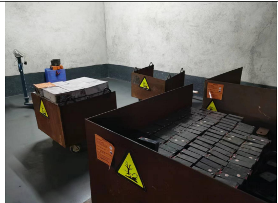
已建成废铅蓄电池贮存区
