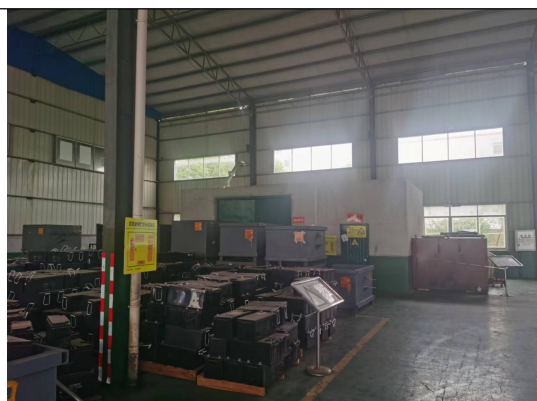
已建成破损电池间
