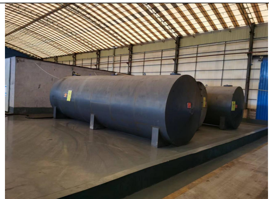
已建成废矿物油储罐区
