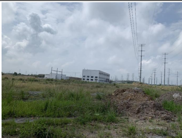
氧化铝厂区东侧华昇 220kV 开关站
