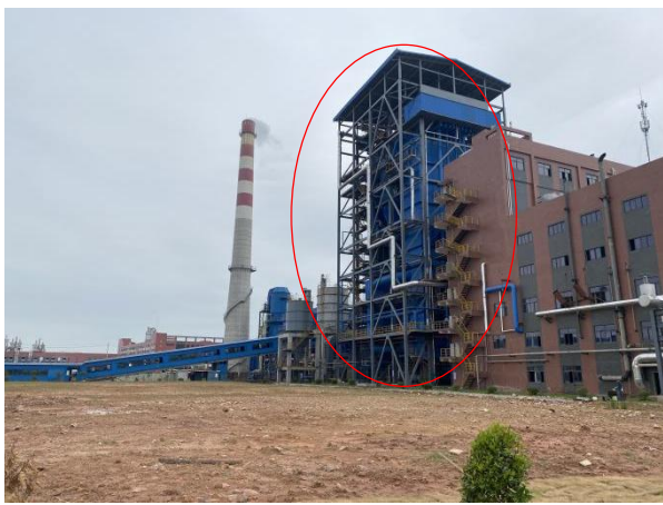
高温高压循环流化床锅炉
