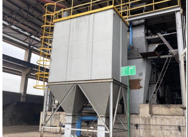
碎煤机配套布袋除尘器
