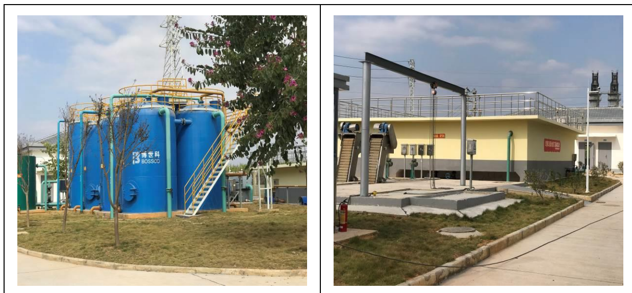
图 5.2-12 黔西污水处理厂现状图
