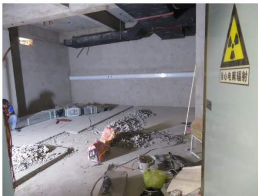
新建 DSA 机房现状
