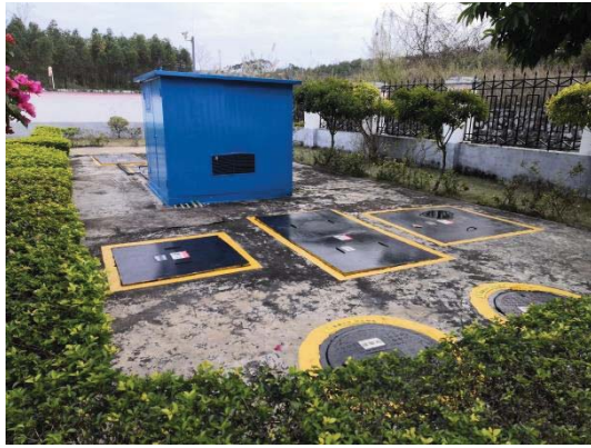
(1) 一体化生活污水处理装置
