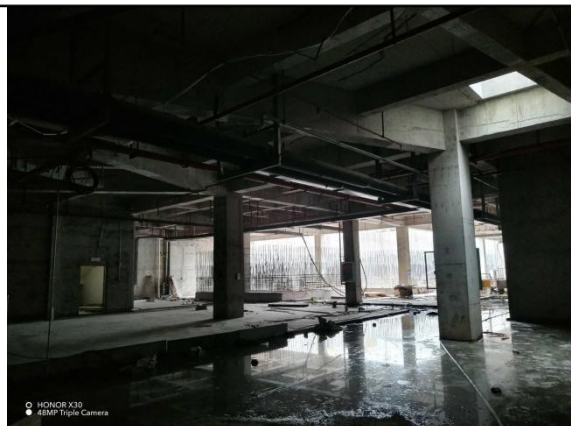
4#地下室负一层放疗科机房
