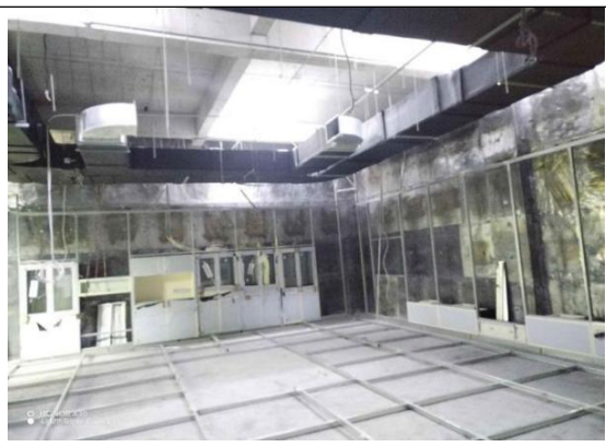
1#门诊医技楼四层手术部DSA机房（1）
