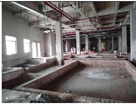
1#门诊医技楼一层核医学科场所（1）
