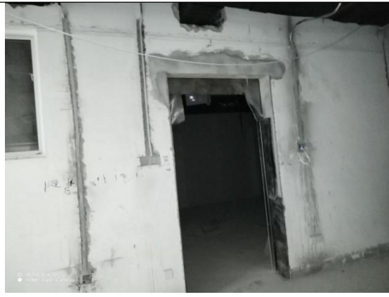
1#门诊医技楼二层内镜中心ERCPC机房
