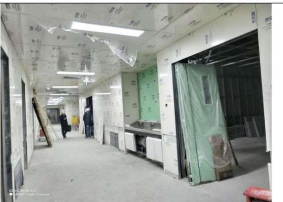
1#门诊医技楼四层手术部 DSA 机房（1）
