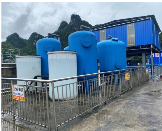
废水处理站（石英砂过滤）
