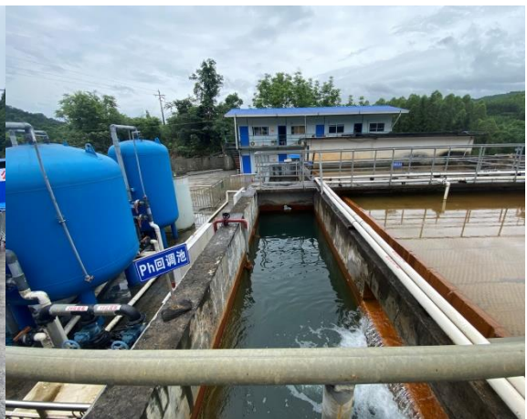
废水处理站（pH回调池）
