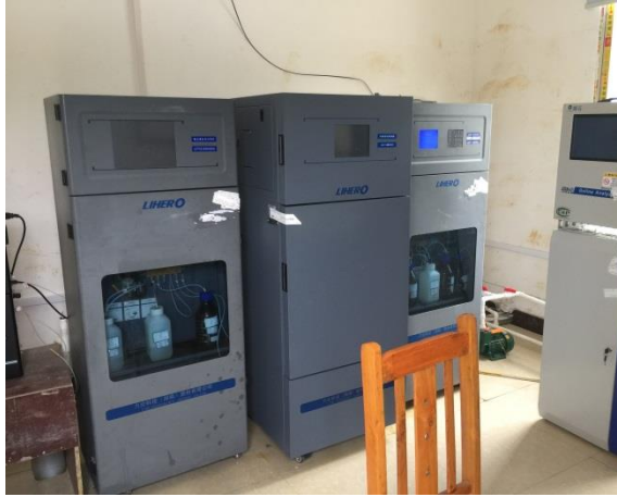
废水处理站（在线监测设备）
