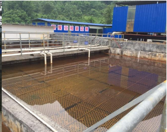
废水处理站（斜板沉淀池）
