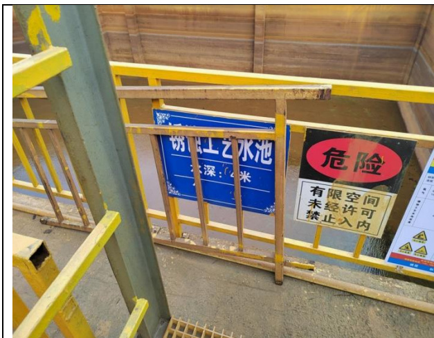
锈蚀工艺水池
