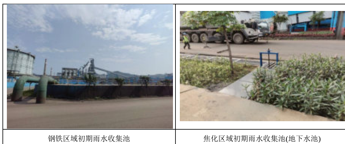
图 3.1-31 初期雨水收集池
