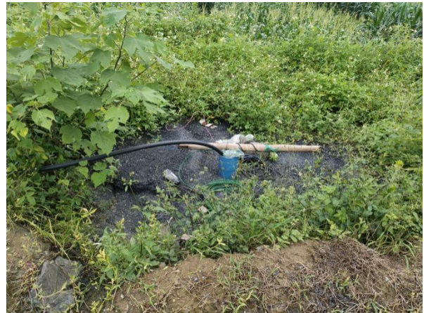
天水屯分散式地下水取水口
