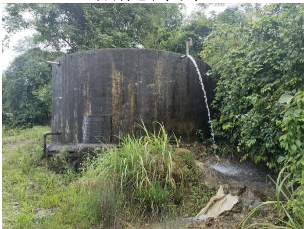
冲乐屯山泉水蓄水池
