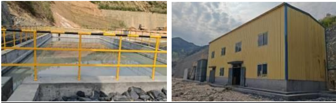
图 4.9-3 南方公司内渗滤液收集池和处理站
